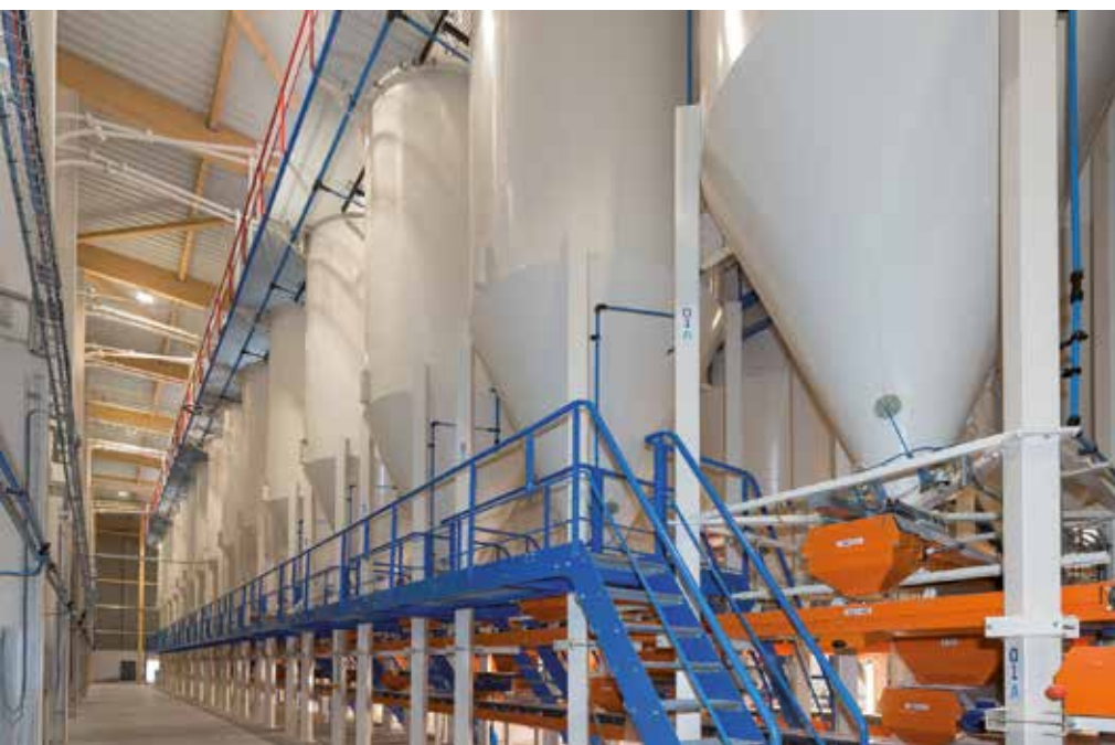
A l'intérieur, pas de broyeur. HGCT s'appuie sur un approvisionnement local, le stockage des matières premières est réparti dans 42 silos.
