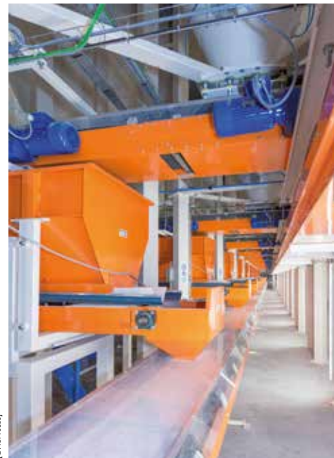
La totalité des tapis de transport est capotée pour limiter au maximum la dissémination des poussières, toutes les matières premières étant pulvérulentes.
